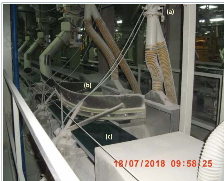
Cintas de transporte: (a) tomas de aspiración; (b) centradores; (c) encapsulamientos [Unimat Prevención]
