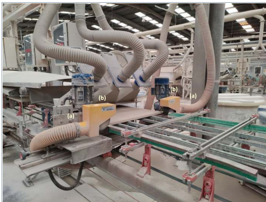
Línea de esmaltado: (a) tomas de aspiración y (b) encapsulamientos, en los rascadores de piezas cerámicas [Unimat Prevención]
